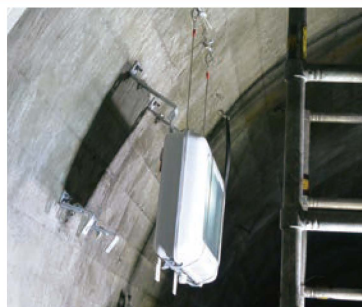
落下防止状況
